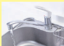
●蛇口の水漏れ
