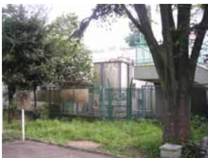
隣接する公園から見える設備機器
