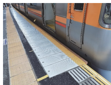
ホームの転落防止ゴム
