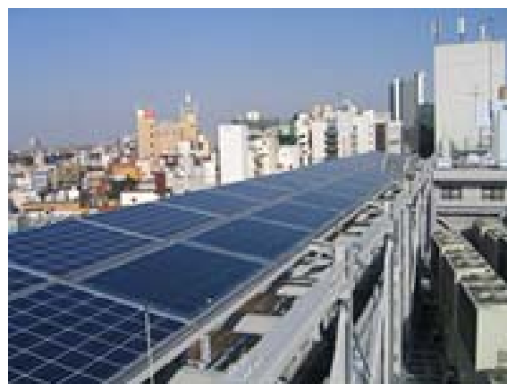
(すぎなみ環境情報館に設置された太陽光発電機器)
