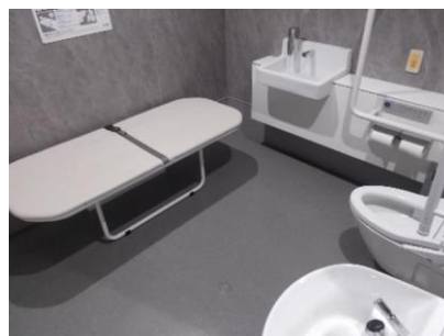
バリアフリートイレ (阿佐谷地域区民センター)
