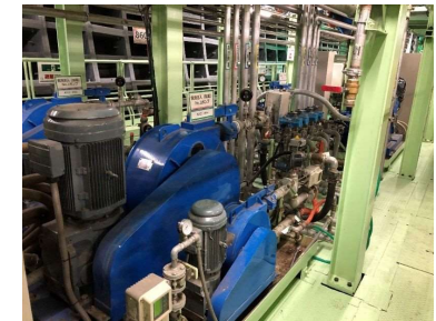
添加材注入ポンプ
