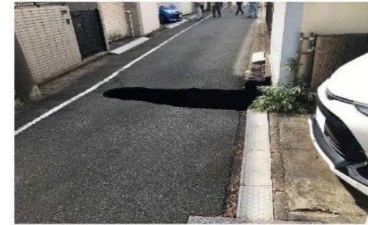
陥没箇所（2020年10月18日 12:30）
