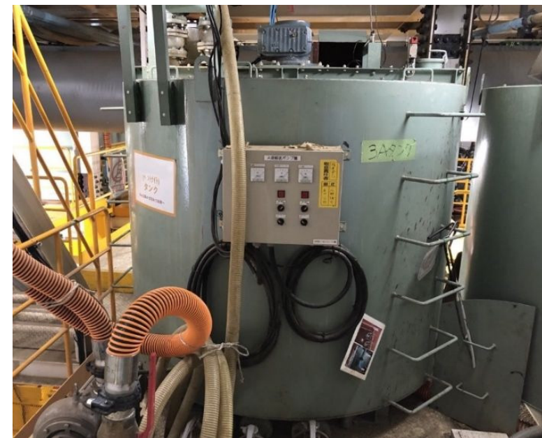
ベントナイト泥水タンク
