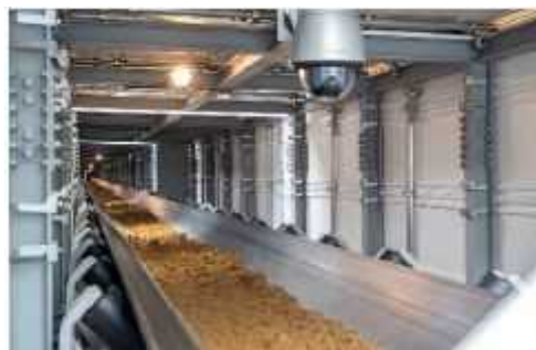
シールドマシンによって掘削した土砂を、 ベルトコンベアに乗せて仮置き場へ搬送する状況 (令和元年9月18日)
