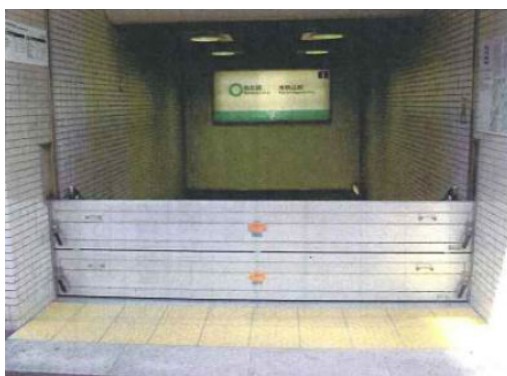
写真 7-3 止水板による地下浸水対策の例
