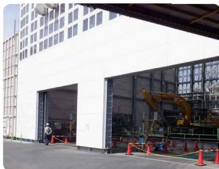
防音ハウス内の状況
