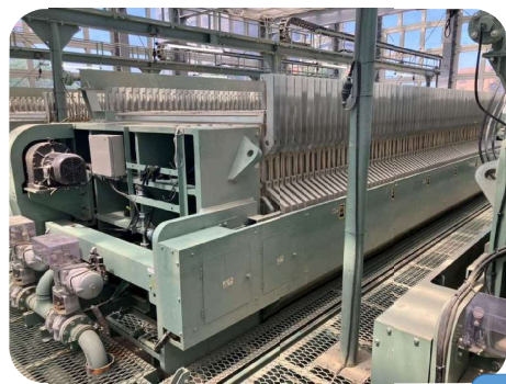
防音ハウス内の設備
