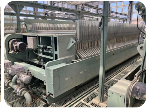
防音ハウス内の設備
