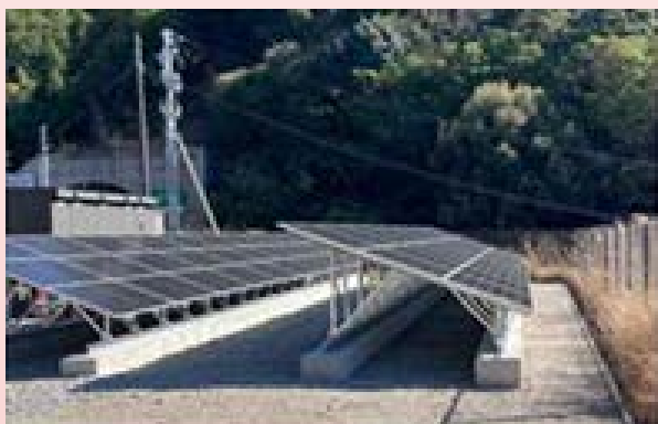
道路脇への太陽光発電施設の設置
