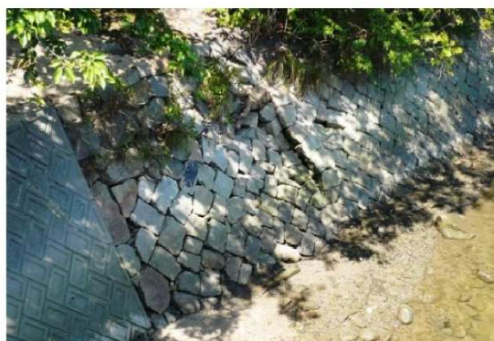
施工前(背面の空洞化により、倒壊の危険あり)
