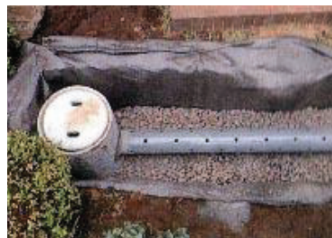
浸透（トレンチ）管
