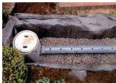
浸透（トレンチ）管
