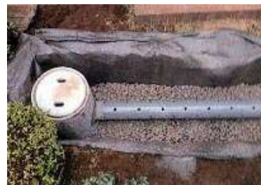
浸透(トレンチ)管
