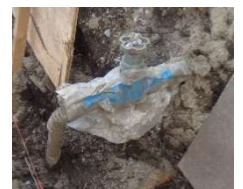
水道管・ガス管
