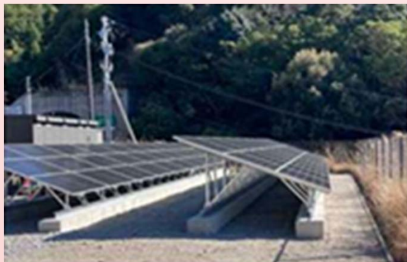
道路脇への太陽光発電施設の設置
