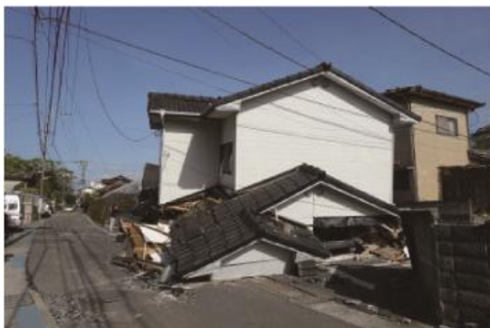
熊本地震被害状況①
