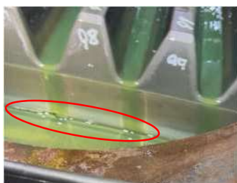
大ギヤの変状状況
