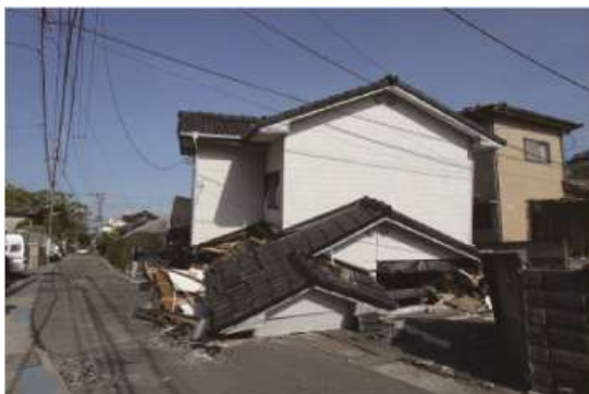
熊本地震被害状況①
