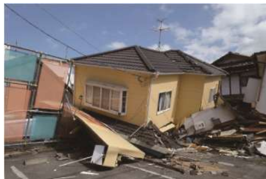
熊本地震被害状況②
