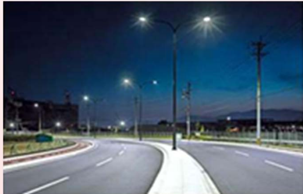
道路照明のLED化
