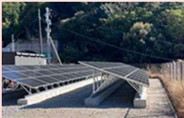
道路脇への太陽光発電施設の設置
