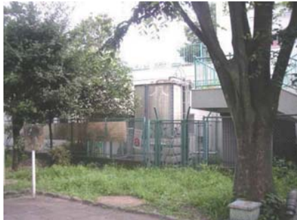
隣接する公園から見える設備機器
