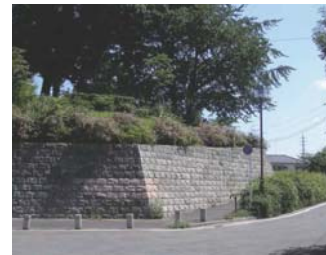
擬石積み (善福寺川緑地)
