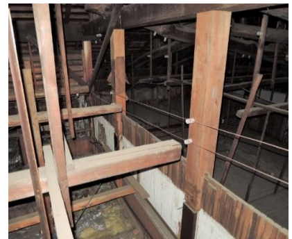
間仕切り壁が梁まで到達していない 状態(荻窪)
