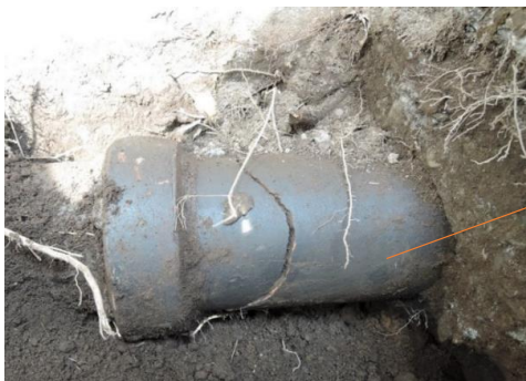
基礎の不同沈下の要因となっていた「書斎」増築部分 基礎下の土管
