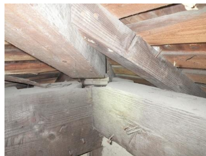
接合部の外れ(駒込移築建物)
